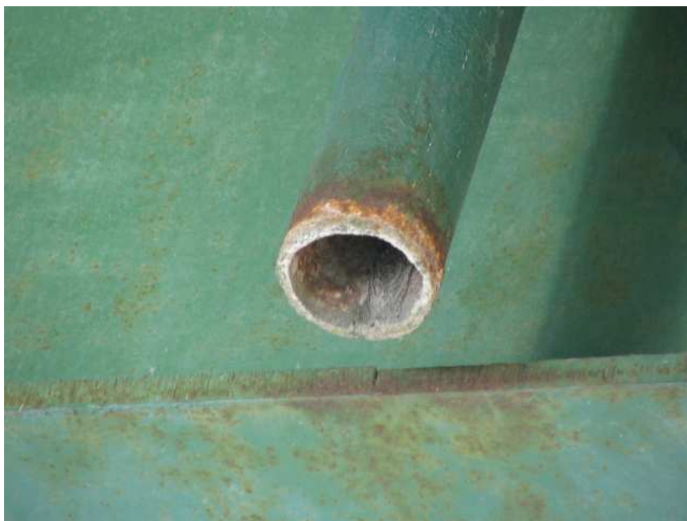
Fot. 24. Początki korozji rury spustowej w przęśle nr 1. Zbyt krótka rura spustowa powoduje zaciekanie wody i korozję pasa dolnego dźwigara
