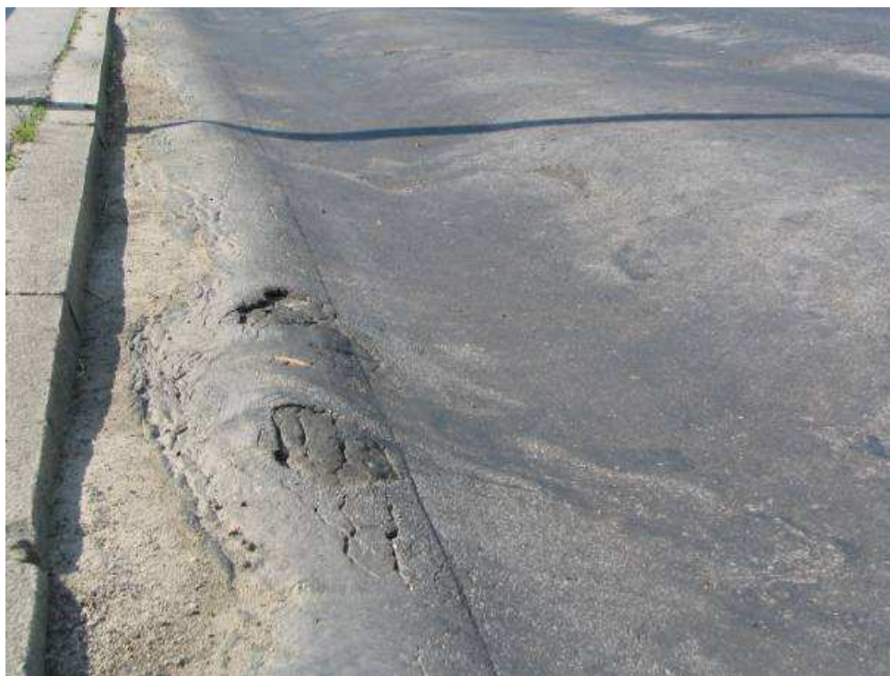
Fot. 5. Pęknięcia nawierzchni jezdni i koleiny o głębokości do 5 cm spowodowane złą jakością materiału nawierzchni, starzeniem materiału i intensywną eksploatacją. Brak spadków poprzecznych utrudnia dopływ wody do urządzeń odwadniających
