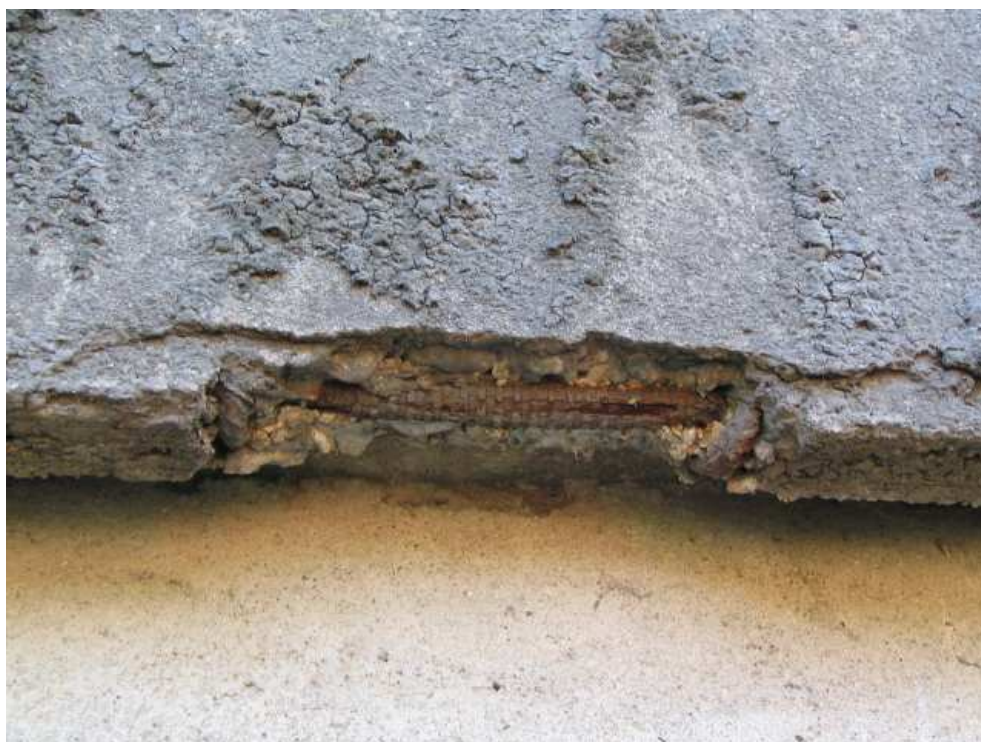
Fot. 23. Ubytki betonu, odsłonięte zbrojenie gzymsu po lewej stronie mostu
