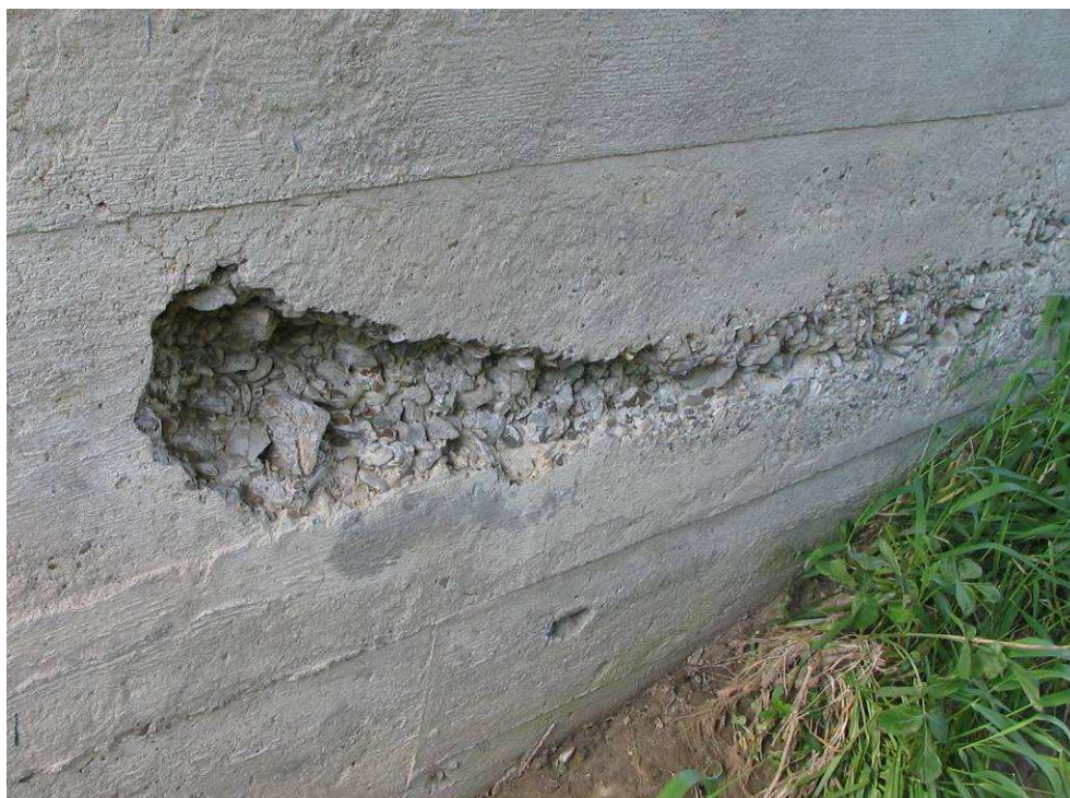
Fot. 17. Ubytki betonu do głębokości ok. 10 cm w korpusie podpory nr 2. Przyczyną ubytków jest zła jakość - niejednorodność betonu z którego wykonano korpus.
