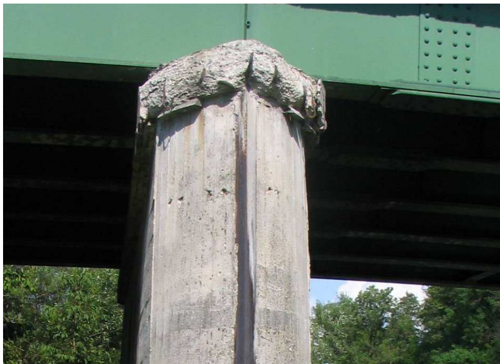
Fot. 16. Ubytki i korozja betonu gzymsu podpory nr 2. Widoczne skorodowane pręty zbrojeniowe
