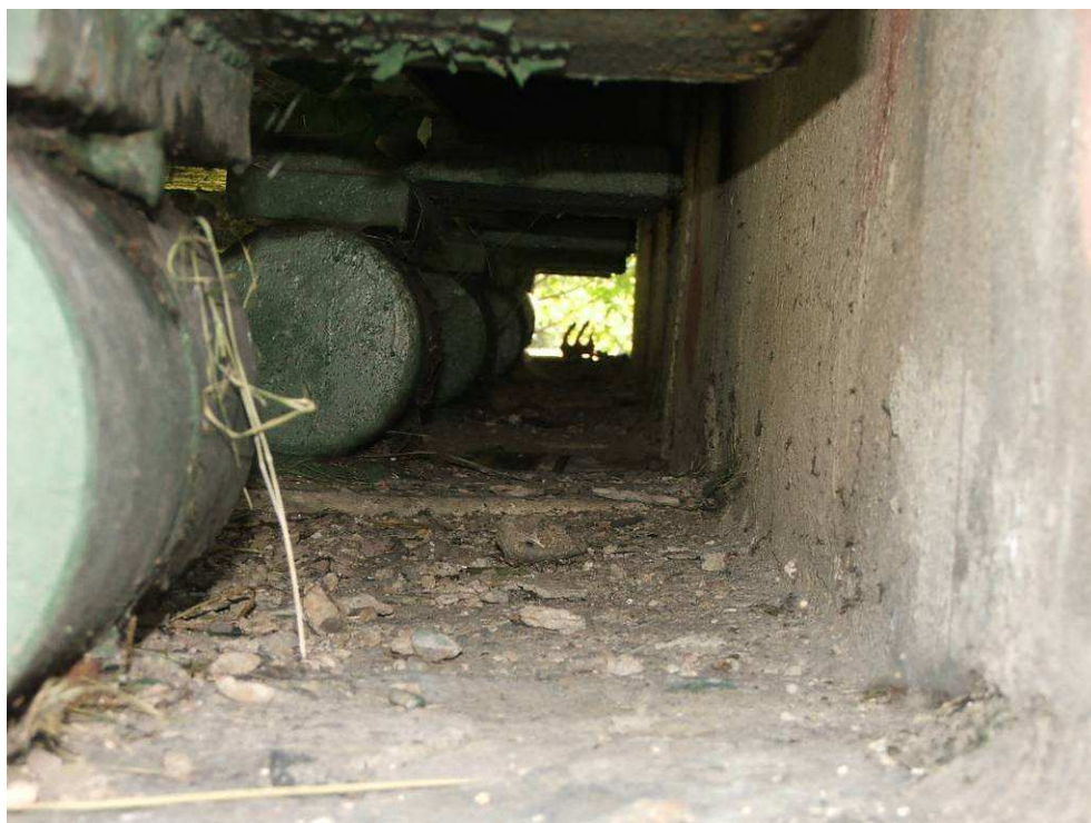
Fot. 14. Zanieczyszczenia ławy podłożyskowej, ciosów i blach dolnych łożysk na podporze nr 1. ograniczające swobodny ruchu przęsła. Przyczyną jest brak systematycznych prac utrzymaniowych
