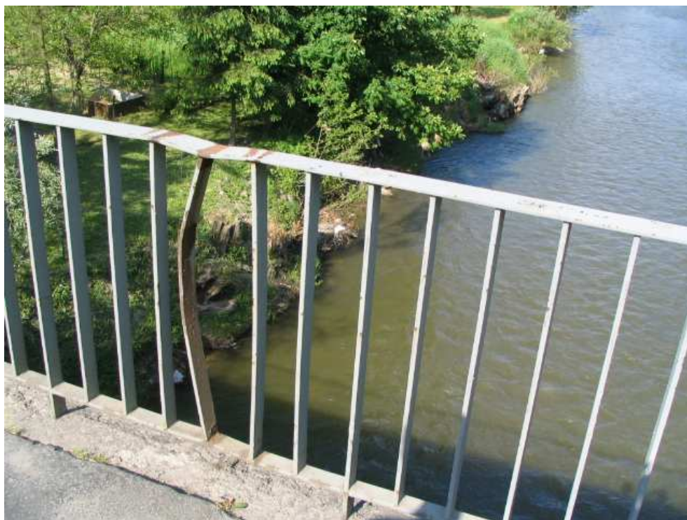
Fot. 10. Zdeformowana balustrada po lewej stronie mostu – widoczne miejsce uderzenia pojazdu
