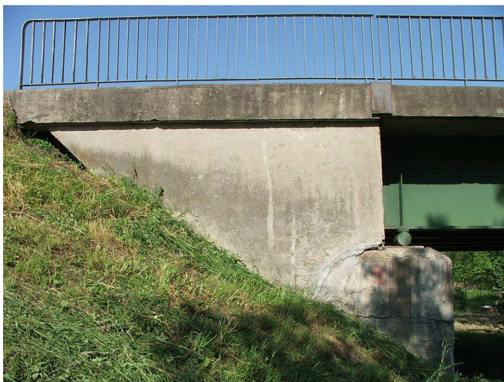
Fot. 12. Zarysowanie i pęknięcia prawego skrzydła podpory nr 1 oraz ubytki stożka nasypu odsłaniające górną część skrzydła
