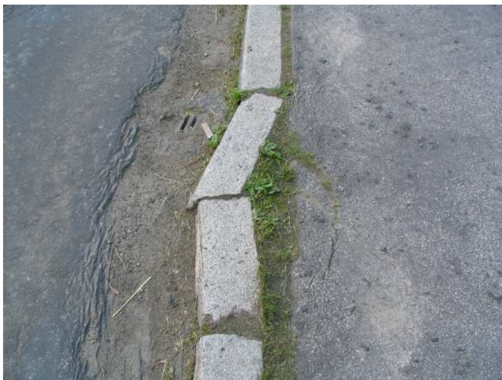
Fot. 6. Przemieszczenie, ubytki i brak spoinowania krawężnika na lewym chodniku; zanieczyszczenie kratki ściekowej i wegetacja roślin
