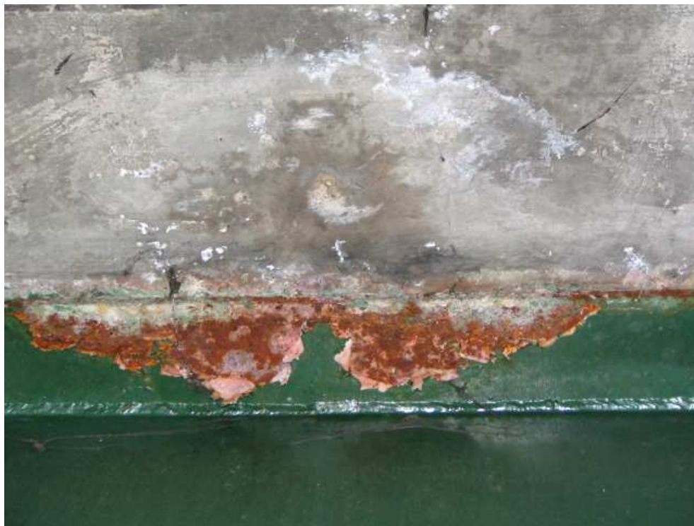
Fot. 20. Przeciek przez płytę pomostu i korozja górnego pasa dźwigara nr 5 w przęśle nr 2. Przyczyną jest miejscowe uszkodzenie izolacji pomostu
