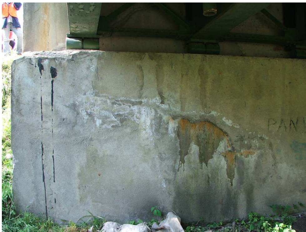
Fot. 15. Korozja betonu, zarysowania i przecieki przez ścianę czołową podpory nr 1. Przyczyną uszkodzeń jest nieszczelna izolacja przyczółka, złe odwodnienie zasypki przyczółka, jezdni i dojazdu do mostu
