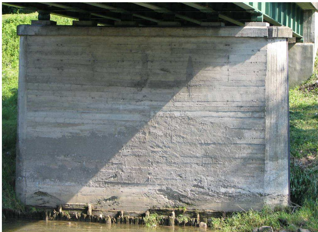
Fot. 18. Raki i ubytki betonu w korpusie podpory nr 3 – największe o głębokości do 5 cm występują w strefie zmiennego poziomu wody
