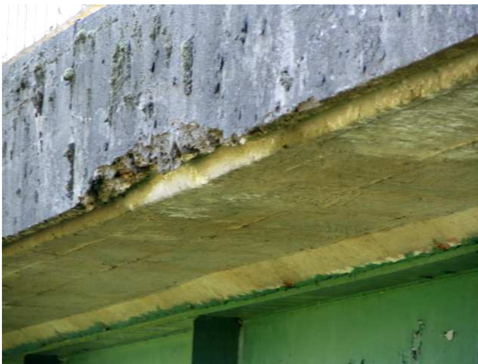
Fot. 22. Korozja betonu i ubytki gzymsu po prawej stronie mostu
