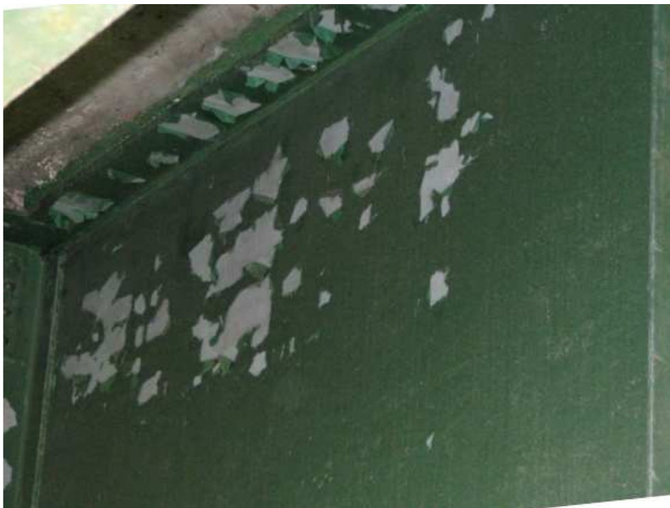
Fot. 21. Typowe dla całego mostu zniszczenie powłoki antykorozyjnej środnika dźwigara głównego - przyczyną jest złe wykonanie prac malarskich
