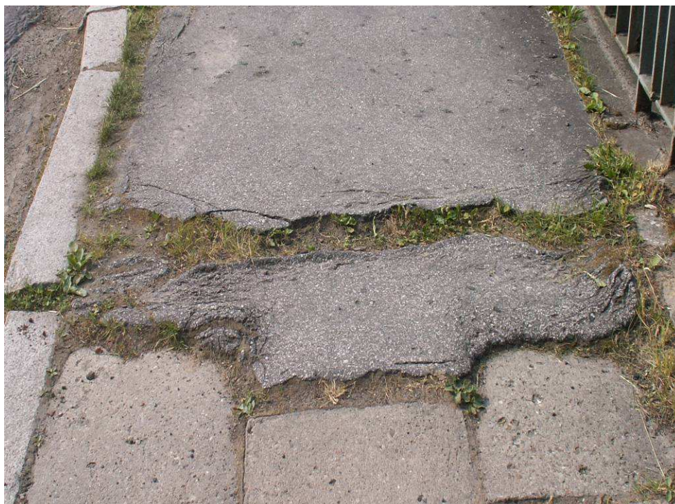
Fot. 8. Pęknięcia, nierówności i wegetacja roślin, na chodniku po lewej stronie mostu – nad podporą nr 4. Przyczyną uszkodzeń jest brak właściwego urządzenia dylatacyjnego i brak systematycznych prac utrzymaniowych
