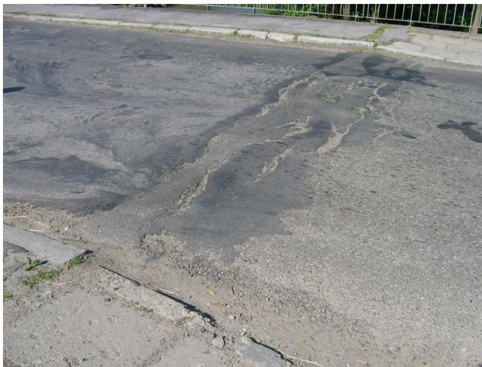
Fot. 7. Spękania i deformacje nawierzchni nad podporą nr 4 (przyczółek od strony Tarnowa) spowodowane brakiem odpowiedniego urządzenia dylatacyjnego. Zbyt mała wysokość krawężników spowodowana ułożeniem wielu warstw nawierzchni
