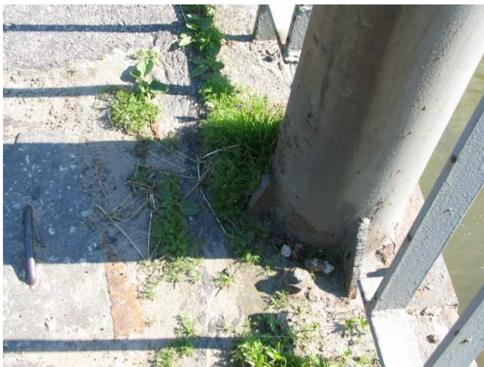
Fot. 11. Wegetacja roślin i zanieczyszczenia w otoczeniu latarni powstałe na skutek braku systematycznych prac utrzymaniowych
