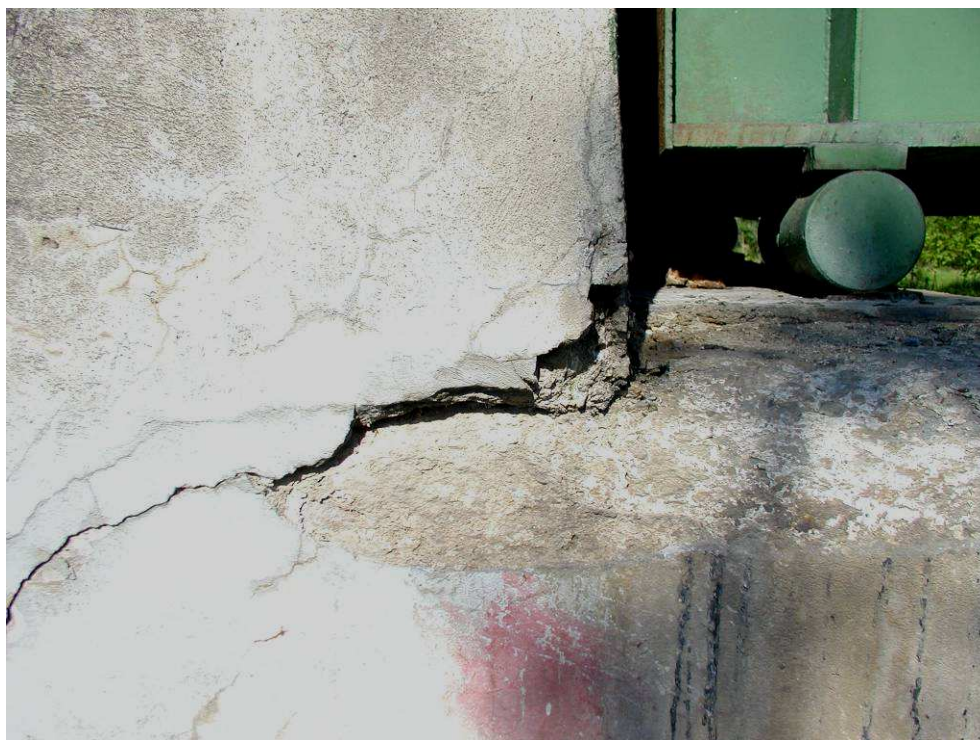
Fot. 13. Pęknięcie skrzydła podpory nr 1 - zbliżenie od strony dołu rzeki. Uszkodzenie prawdopodobnie jest spowodowane złym odwodnieniem przyczółka i zanieczyszczeniem szczeliny dylatacyjnej
