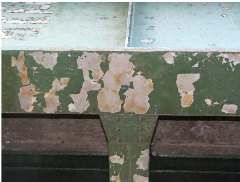
Fot. 19. Charakterystyczne dla całego mostu zniszczenie powłoki antykorozyjnej na pasie dolnym dźwigara
