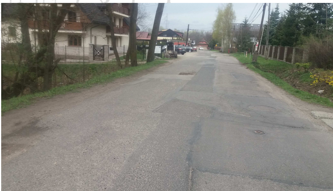
fot. 2 Widoczne wyboje i spękania siatkowe
