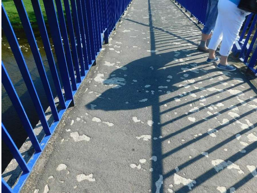
Rys. 2. Widok na zniszczoną nawierzchnię na obiekcie
