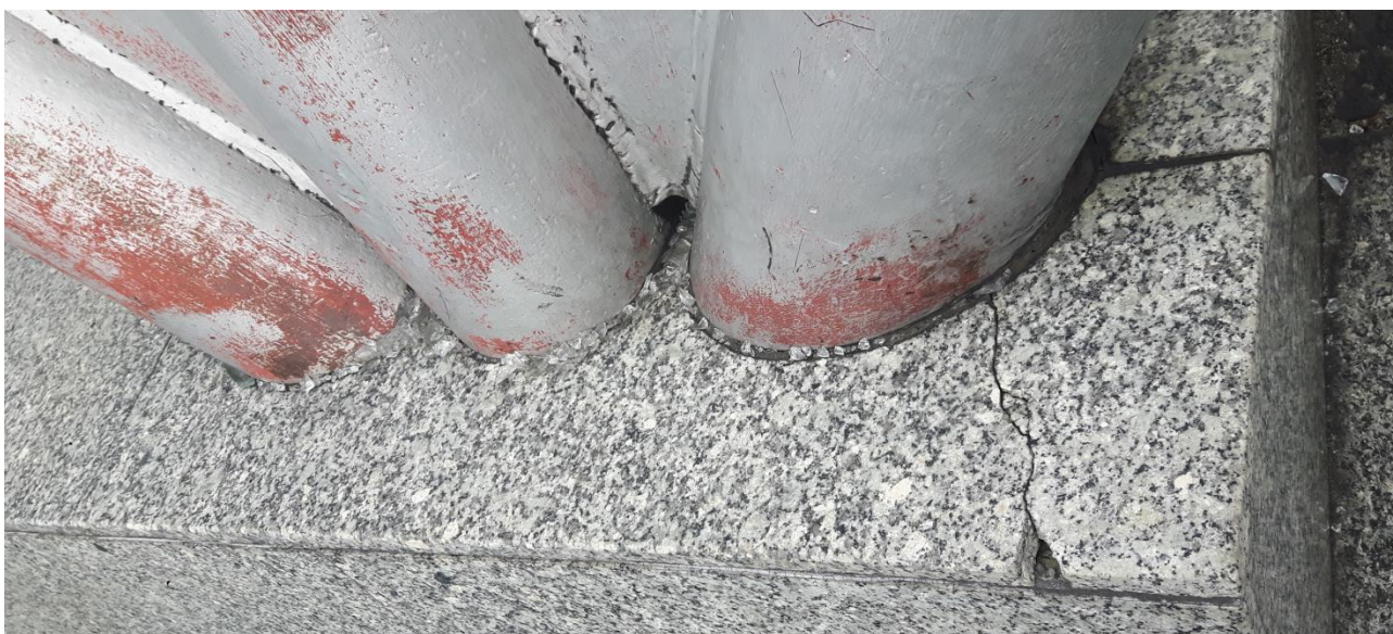
Fot. nr 7. Pęknięcia płyt okładzinowych przy fundamentach stalowych łuków zadaszenia sceny.
