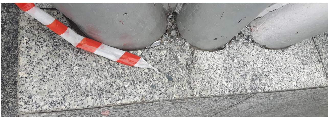
Fot. nr 6. Pęknięcia płyt okładzinowych przy fundamentach stalowych łuków zadaszenia sceny.
