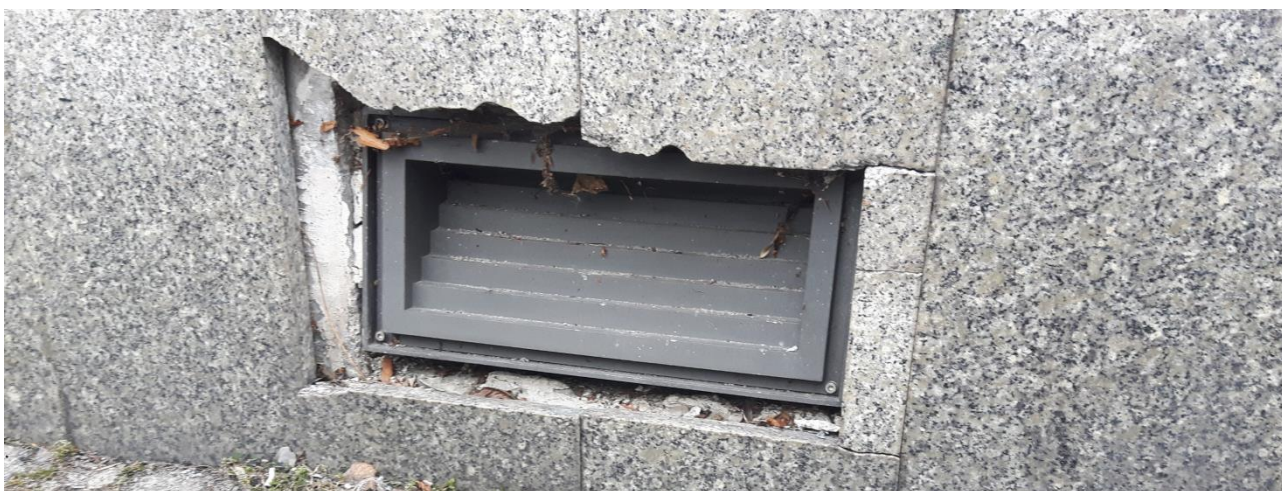
Fot. nr 10. Uszkodzenie płyt granitowych i opraw oświetleniowych.
