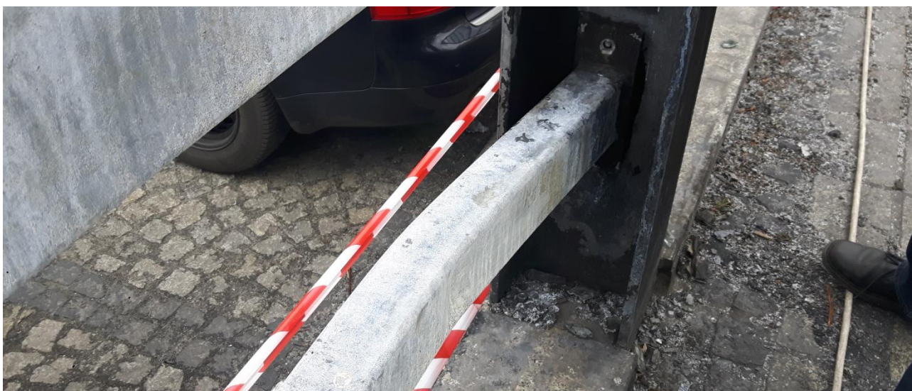
Fot. nr 4. Mechaniczne uszkodzenie rygla w sąsiedztwie sceny.
