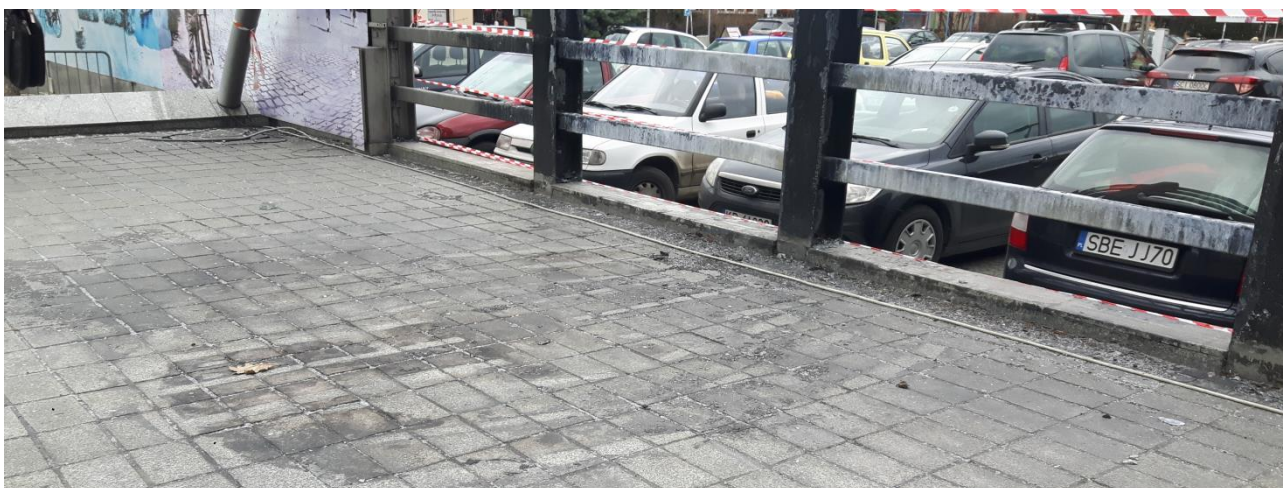
Fot. nr 5. Zabrudzenia posadzki sceny po pożarze.
