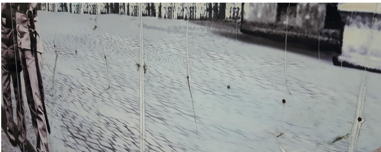
Fot. nr 9. Uszkodzenia płyt z reklamami na palisadzie.
