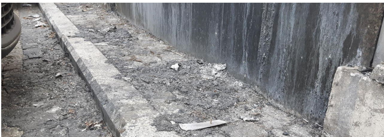
Fot. nr 8. Zabrudzenia kostki granitowej na parkingu.
