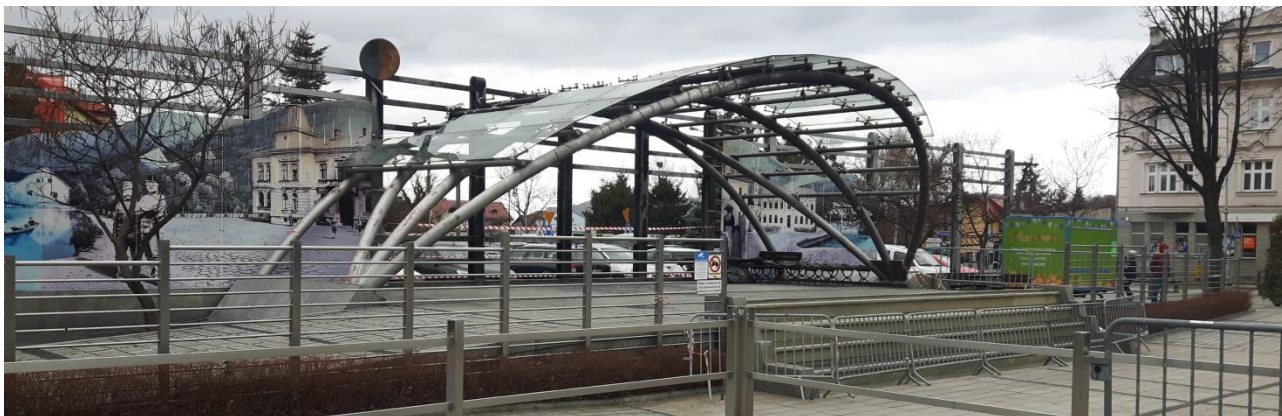
Fot. nr 1. Widok sceny po pożarze od strony widowni.
