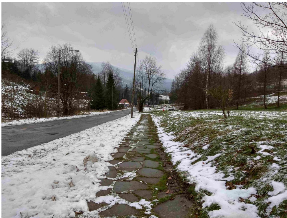
Rysunek 19. Stan techniczny chodnika wzdłuż ul. Wczasowej. Chodnik z płyty kamiennej.
