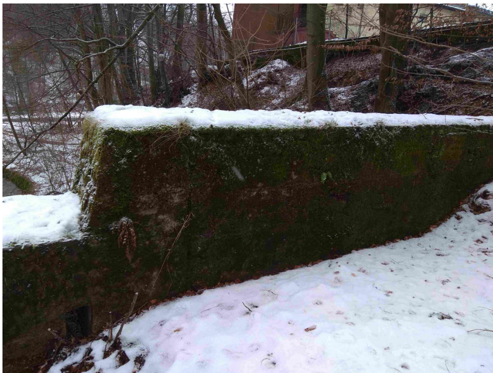
Rysunek 34. Stan techniczny zapory przeciwrumszowej nr 2.
