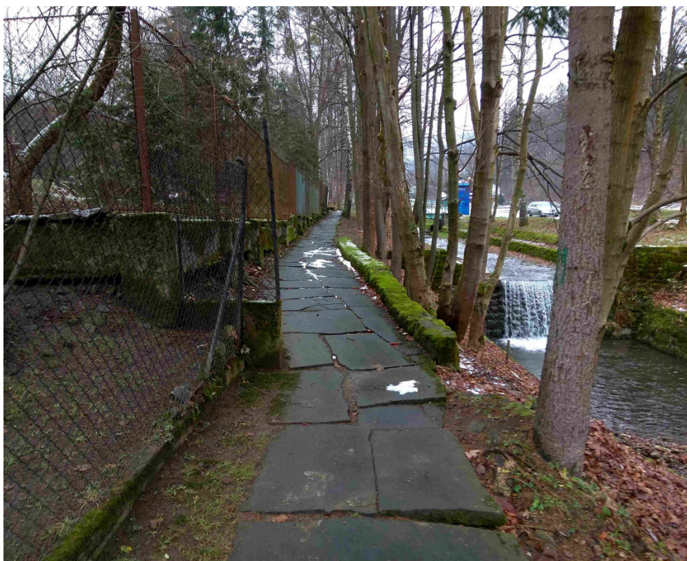
Rysunek 7. Stan techniczny nawierzchni chodnika oraz muru oporowego przy ciągu pieszym w pobliżu ul. Wczasowej wzdłuż strumienia Jaszowiec na wysokości Karczmy Jaszowianka.
