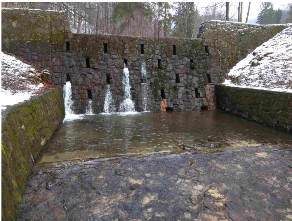
Rysunek 23. Stan techniczny zapory przeciwrumszowej nr 1 wraz ze skarpą i dnem strumienia Jaszowiec.
