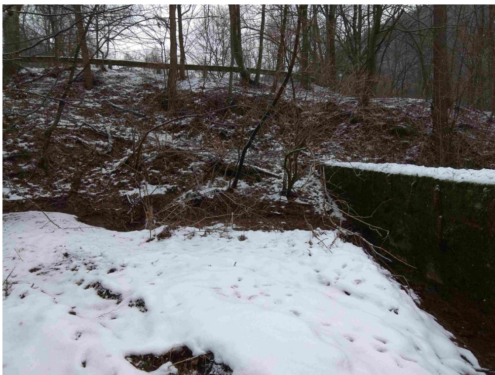
Rysunek 35. Widok na skarpe przy zaporze przeciwrumszowej nr 2.
