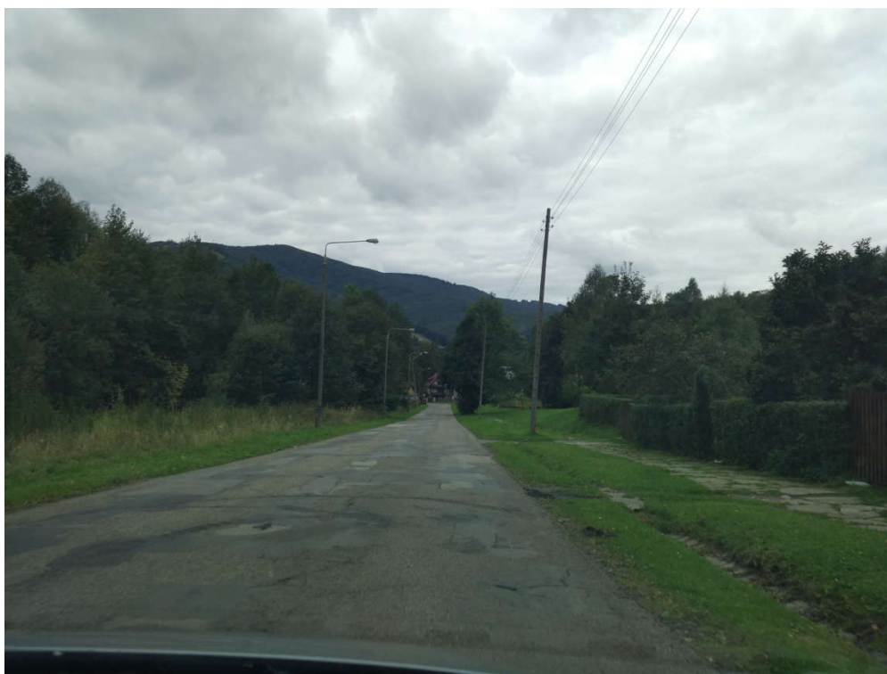
Rysunek 5. Widok na stan techniczny drogi dojazdowej na ul. Wczasowej.
