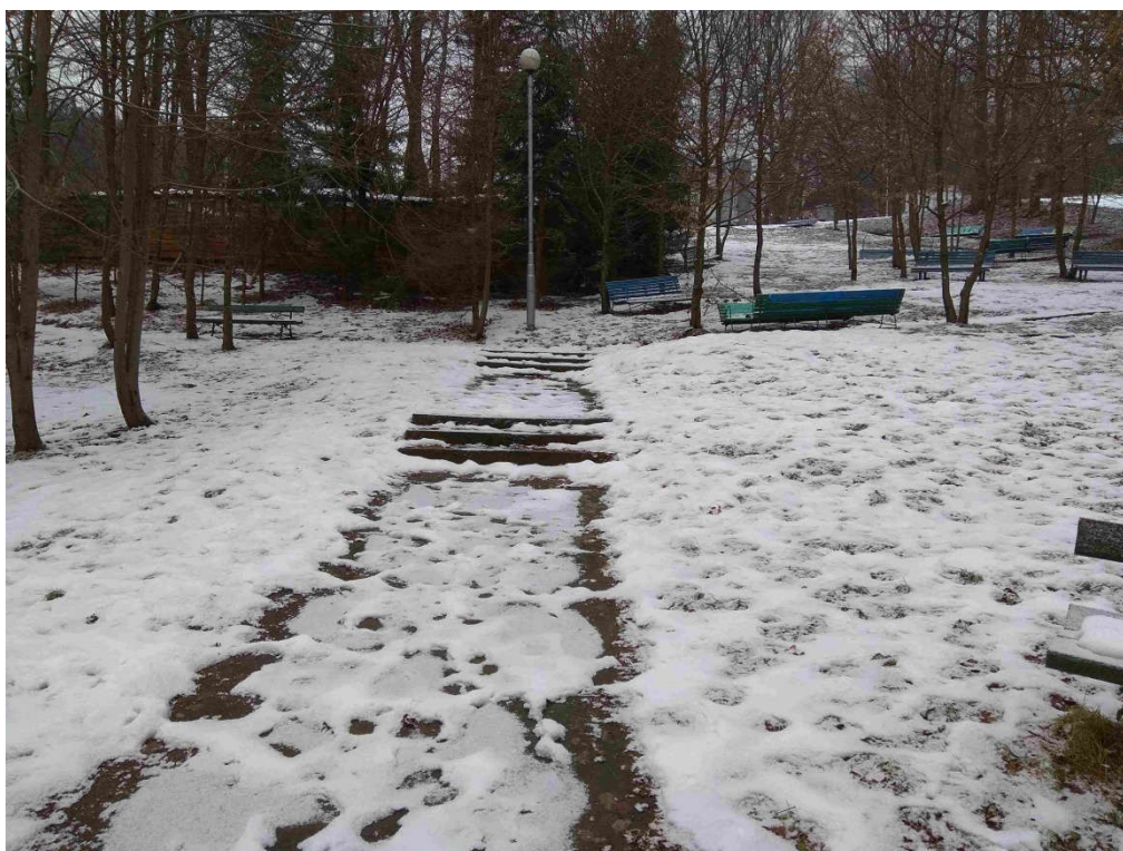
Rysunek 26. Stan techniczny schodów z kostki kamiennej wraz z elementami małej architektury przy Domu Wczasowym Kolejarz.
