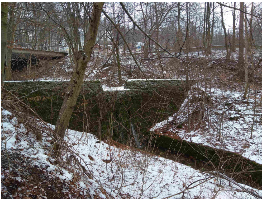
Rysunek 31. Widok z przodu na zaporę przeciwrumszową nr 2.
