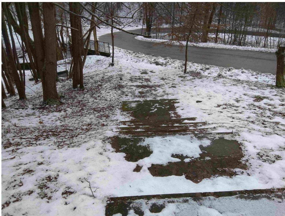
Rysunek 25. Stan techniczny schodów z kostki kamiennej prowadzących do Domu Wypoczynkowego „Kolejarz”.
