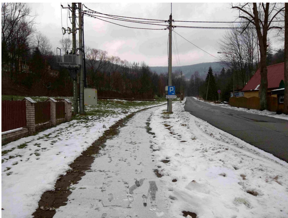
Rysunek 16. Stan techniczny chodnika przy ul. Wczasowej na wysokości stacji narciarskiej Palenica.
