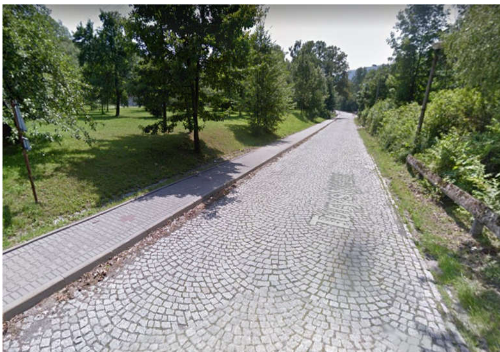
Rysunek 44. Stan drogi na ul Turystycznej wraz z chodnikiem przy skrzyżowaniu z ul. Wczasową w stronę Wisły.
